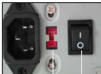
Przełącznik napięcia wejścia prądu zmiennego
